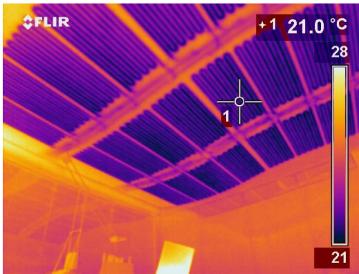
Vista con termocamera IR di soffitto radiante conformato a onda e decorato (in fase di raffreddamento)
