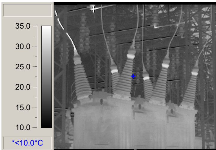
Figura 1: il passante sinistro risulta decisamente più freddo rispetto agli altri
